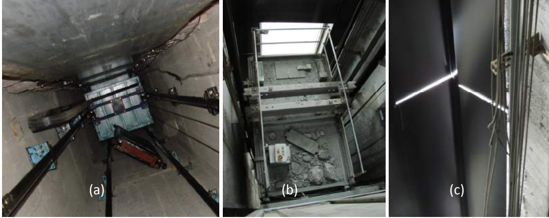
Şekil 2. (a) Karşı ağırlığın raydan çıkması ve kabinle çarpışması (b) Karşı-ağırlık dilimlerinin kabin üzerine düşmesi (c) MDA'de halatların braketlere takılarak kopması
